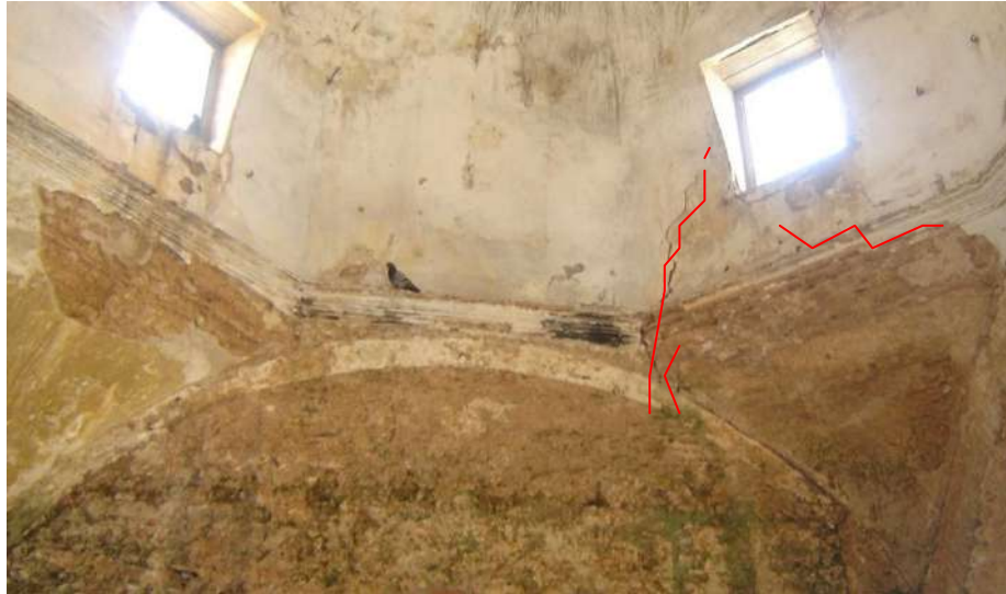
Fig. 227 : Dégradation du mur nord-ouest, pavillon de musique.
