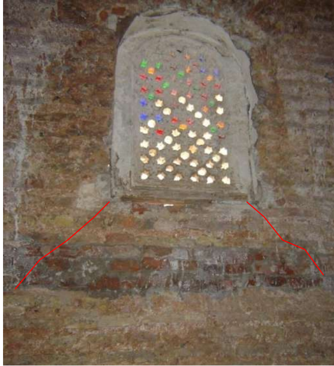
Fig. 183 : Pan Est de la grande coupole, mosquée du Dey. Deux fissures au niveau de la fenêtre inclinée à 45°.
