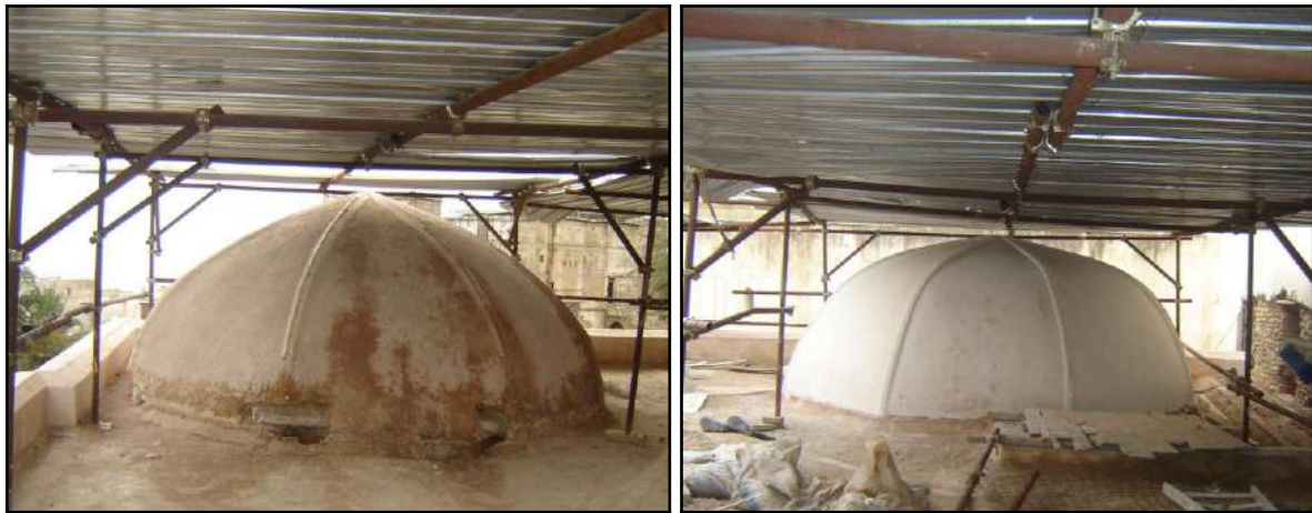
Fig. 174 : Position des huit nervures externes sur les arêtes de l'extrados, coupolettes de la mosquée du Dey.
