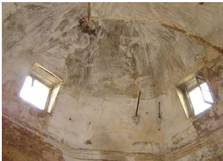
Fig. 228 : Fissures superficielles des pans du côté Nord-est, pavillon de musique.
