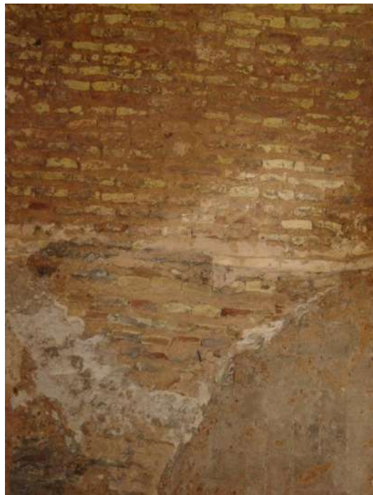
Fig. 218 : Intervention contemporaine sur le pendentif, coupole du bain des Aghas. Le pendentif comporte des traces de mortier de ciment indiquant des réfections contemporaines.
