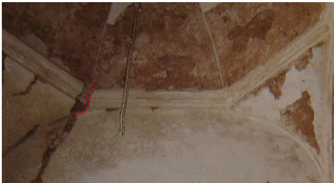
Fig. 198 : Les dégradations du mur sud-est, coupolette « D », mosquée du Dey.
