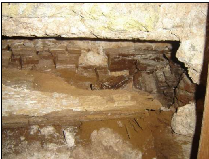
Fig. 187 : Détérioration des tirants en bois, grande coupole de la mosquée du Dey.
