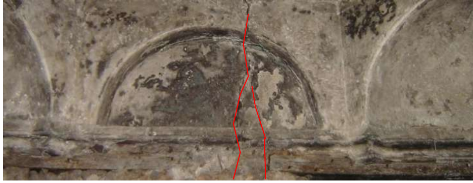
Fig. 212 : Dégradation relevée sur les pans Sud-ouest, mur d'entrée, bain du Harem. -Fissure verticale entre 2 à 3mm, traversant toute la zone de transition.
