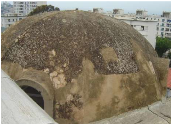
Fig. 224 : L'extrados de la coupole, côté Sud-est, pavillon de musique.
