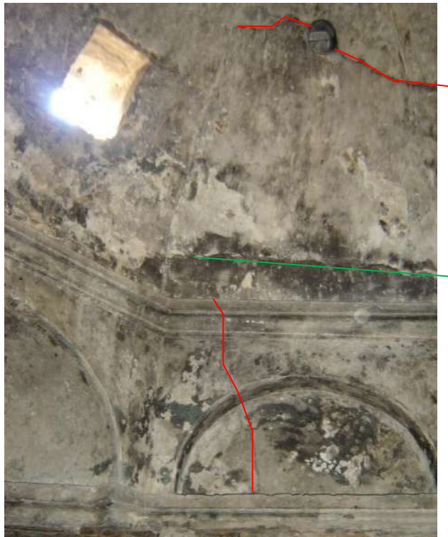
Fig. 213 : Dégradation des pans nord-ouest, bain du Harem. -Fissure verticale de 1 à 2mm traversant la zone de transition et la corniche. -Les pans comportent des fissures d'enduit horizontale marqués par des taches noires et grises.
