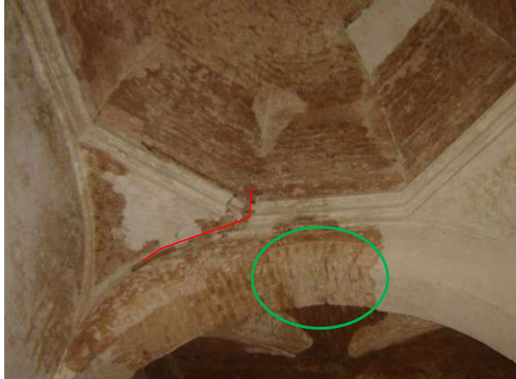
Fig. 194 : Dégradations de l'arc sud-ouest, coupolette « C », mosquée du Dey.
