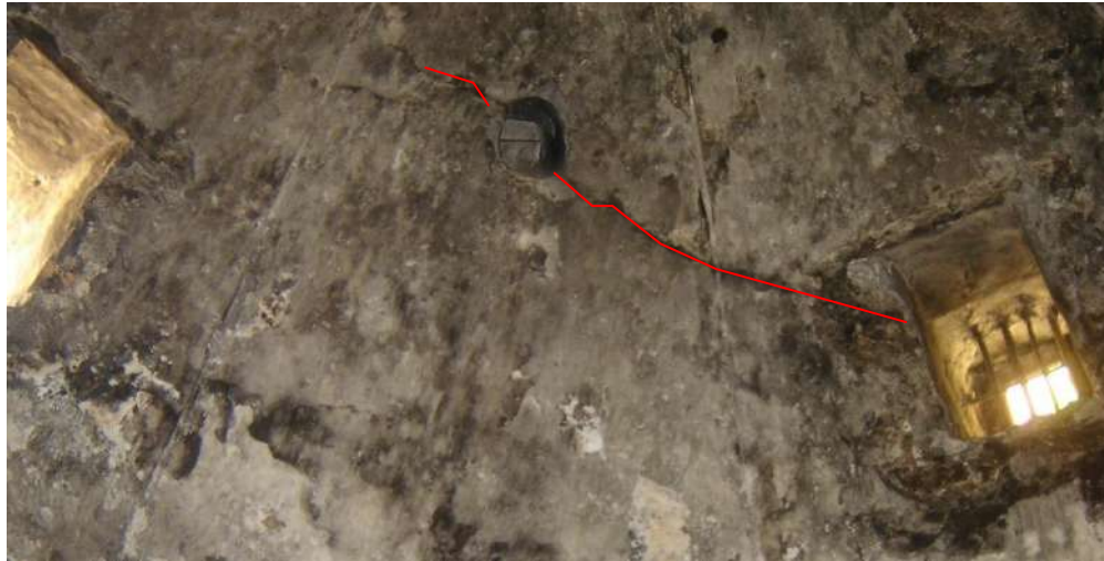
Fig. 208 : Dégradations des pans Nord et Est, bain du Harem.
