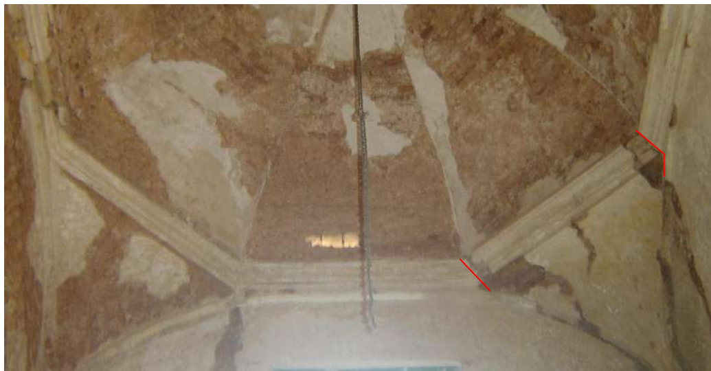
Fig. 200 : Dégradations du mur nord-est, coupolette « D », mosquée du Dey.
