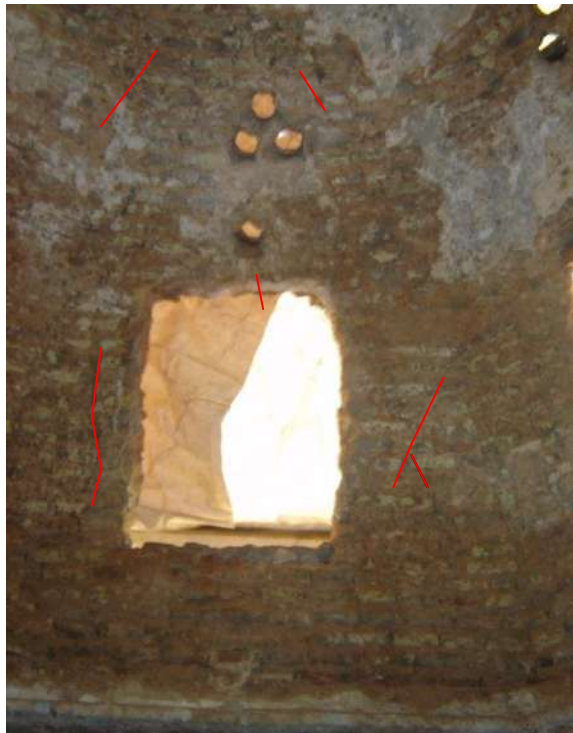
Fig. 216 : Les détériorations du pan n° 2, coupole du bain des Aghas.
