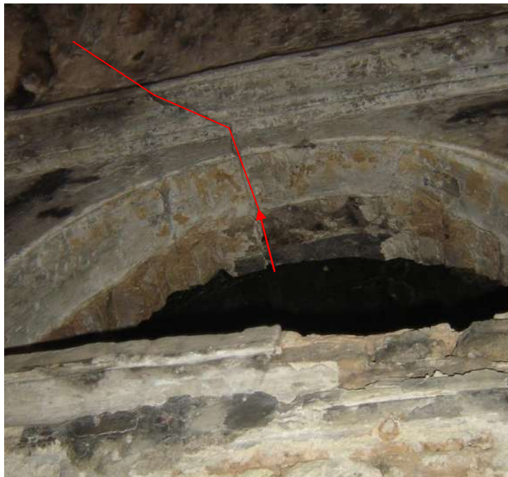
Fig. 211 : Détérioration de l'arc, bain du Harem.
