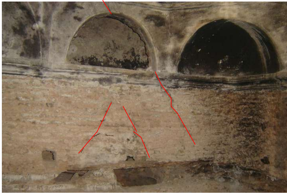
Fig. 210 : Les dégradations au niveau du mur porteur, bain du Harem.
