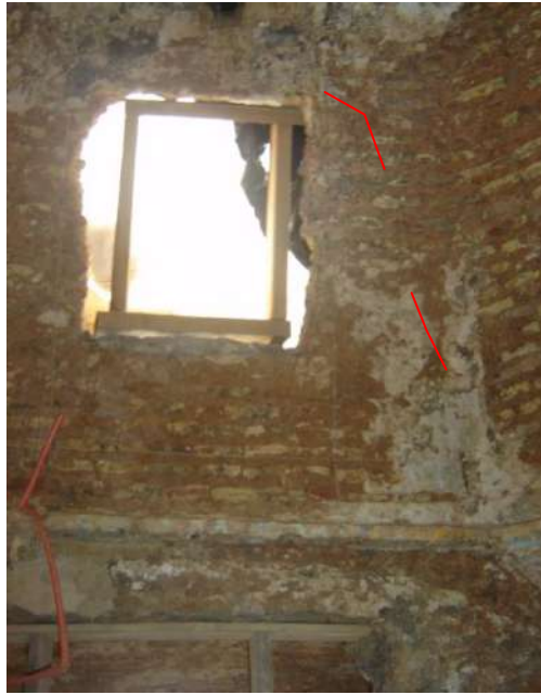
Fig. 215 : Les dégradations du pan n° 1, en-dessous de l'entrée, coupole du bain des Aghas. Le percement de la fenêtre avec l'introduction d'un mortier différent a causé plusieurs fissures superficielles. Ces ouvertures ne sont pas axiales comme c'est le cas dans les autres coupoles inventoriées. Trois ouvertures se suivent sur les trois premiers pans à compter de l'entrée. Ceci contribue à la déstabilisation de la structure.
