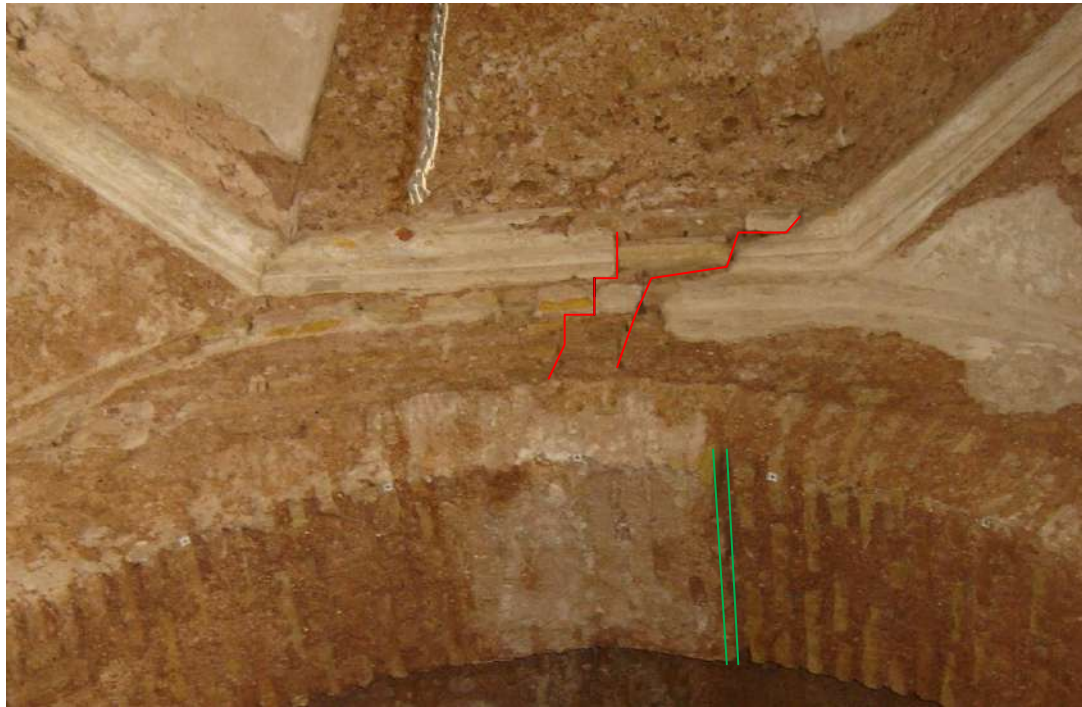
Fig. 199 : Les dégradations de l'arc nord-ouest, coupolette « D », mosquée du Dey.
