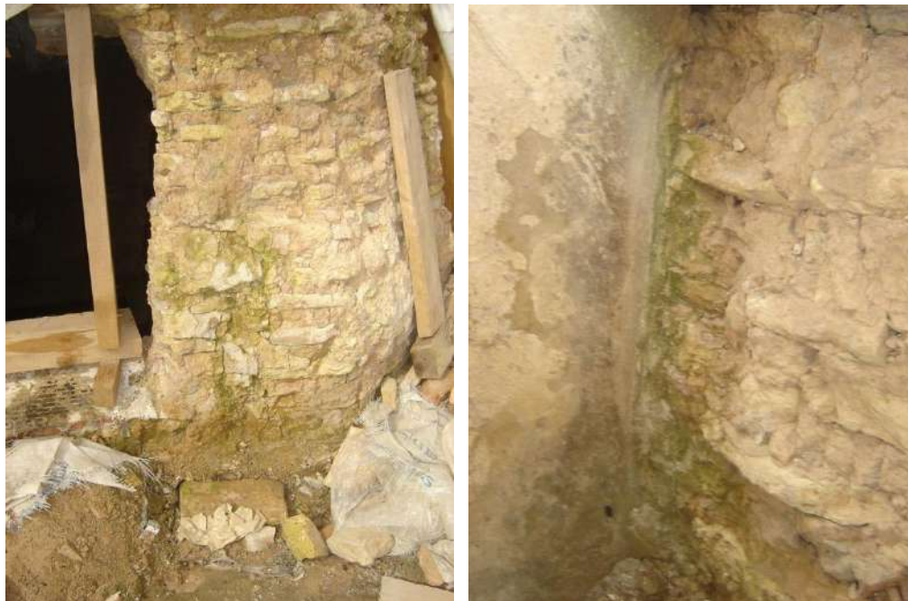
Fig. 219 : Les dégradations de l'extrados, coupole du bain des Aghas.
