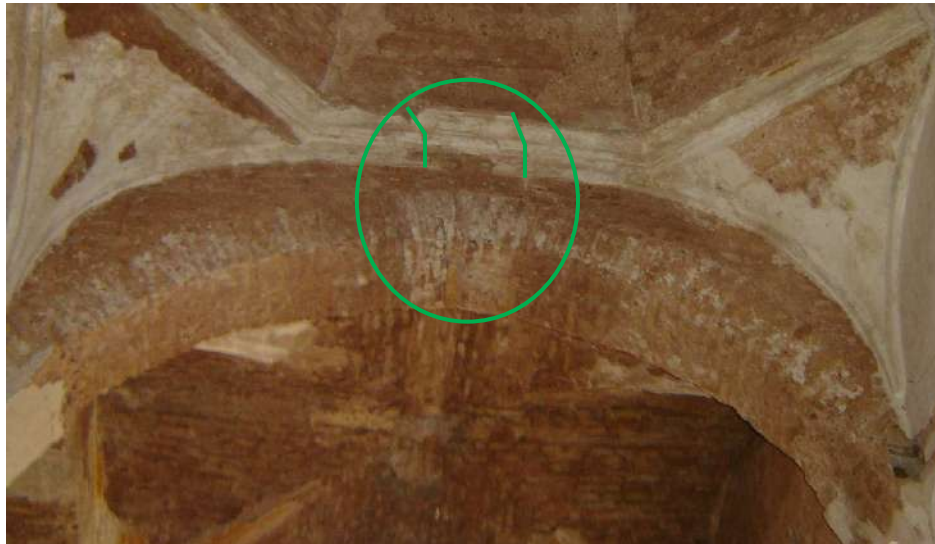
Fig. 195 : Fissures superficielles, arc nord-est, coupolette « C », mosquée du Dey.
