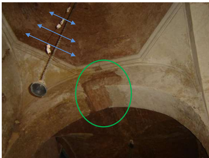
Fig. 192 : Fissure superficielle, arc nord-ouest, coupolette « B », mosquée du Dey.
