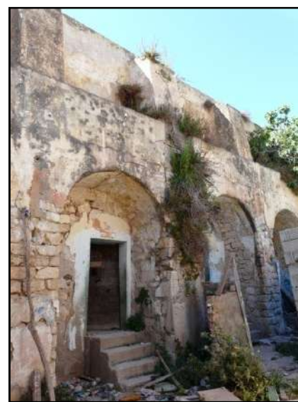
Ph 17. Façade Est du bâtiment (D), renforcée par des contreforts. (S. Hassam)
