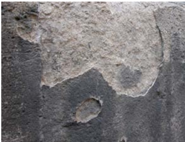
Figure 39 : Le sulfite empêche la pierre de respirer et se détache par plaques, laissant apparaître les pierres altérées par l'humidité. Source : (JB Blom, Caroline Fogliani & DAC, Avril 2009)
