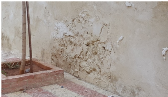
Figure 116 : Une réhabilitation mal faite (3) photo prise décembre 2015
