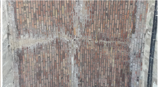
Figure 115: fissure au niveau de la voute en berceau (1) photo prise décembre 2015
