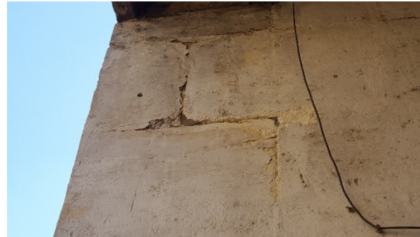
Figure 117 : détachement de l'enduit au niveau des joints entres les pierres (1) photo prise décembre 2015
