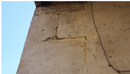
Figure 261 : joint qui endommagé Photo prise décembre 2015
