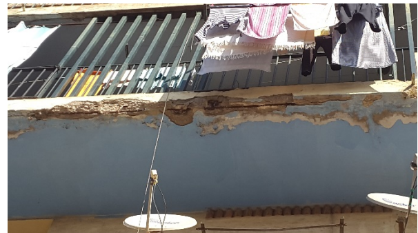
Figure 119 : des brises de soleilles en état dégradé (4). Photo prise décembre 2015
