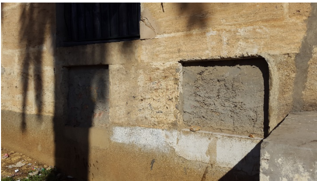
Figure 136 : La fermeture des fenêtres pour les caves (15). Photo prise décembre 2015
