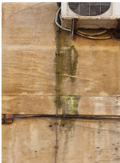
Figure 129 : les traces d'humidité(11). Photo prise décembre 2015
