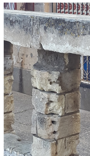
Figure 131 : L'éclatement causé par un choc mécanique (13). Photo prise décembre 2015
