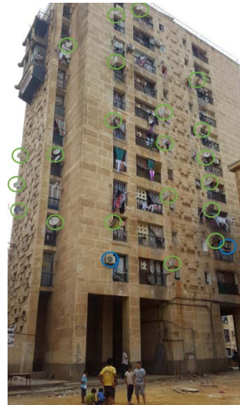
Figure 187 : l'état actuel des façades Sud- Est et Sud- Ouest Photo prise décembre 2015
