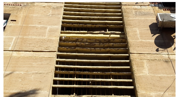
Figure 121 : dégradation qui touche le bas du plancher plain en béton armé (l'apparition de l'acier) (4) Photo prise décembre 2015
