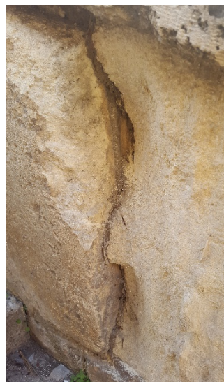
Figure 130 : Altérations des joints à cause de l'action du vent et des pluies battantes (12). Photo prise décembre 2015
