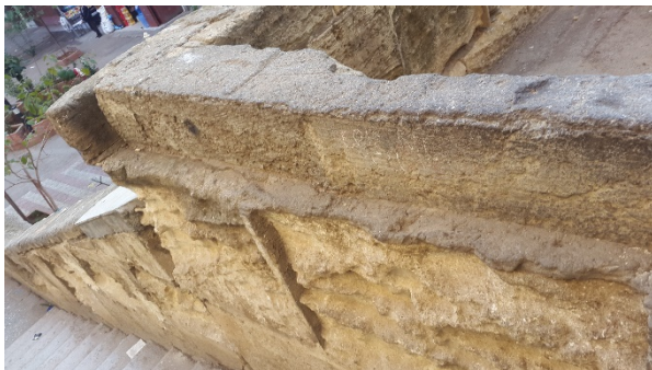
Figure 118 : détérioration du plancher translucide (6). Photo prise décembre 2015
