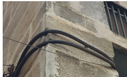
Figure 262 : risque de chute d'une pierre a cause du câble d'électricité (pierre et joint endommagés) Photo prise décembre 2015
