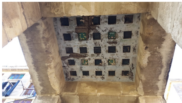
Figure 120 : la dégradation de la pierre utilisée pour les espaces publique (gardes corps, les murs de soutènement ...) grâce à l'humidité et au choc (3) Photo prise décembre 2015
