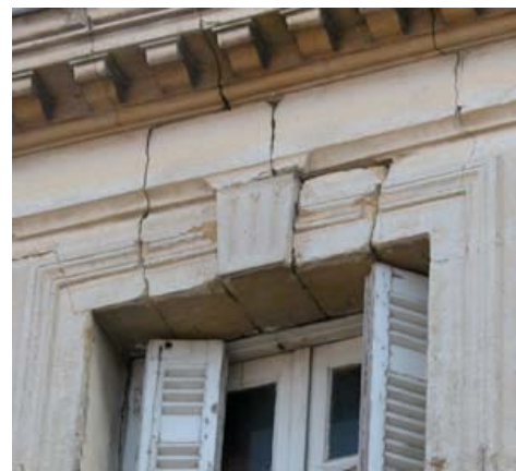
Figure 40 : Les fissures ou lézardes
