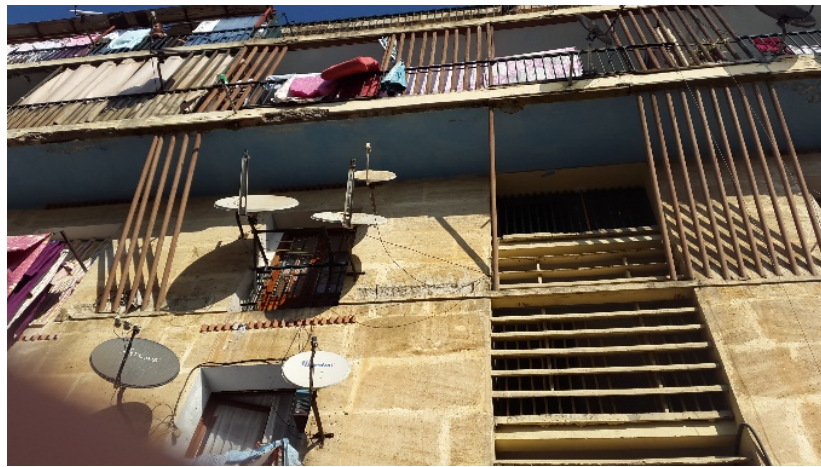
Figure 125 : Détachement des éléments décoratifs en bois en dessous de la dalle en béton armé (4) Photo prise décembre 2015
