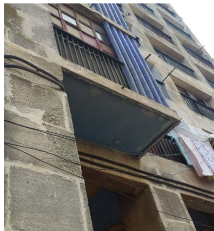
Figure 158 : dalle plane Photo prise décembre 2015
