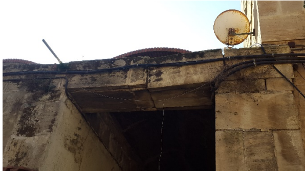
Figure 114 : détachement de pierre banché (1) photo prise décembre 2015
