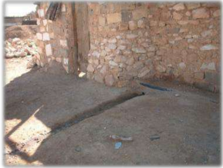
Figure 132 : évacuation des eaux usées à l'extérieur et à l'air libre (Source : Sofrani K , Juin 2009)
