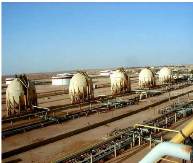
Figure 15 : Sphères de stockage de GPL, Centre de Stockage et de transfert des fluides, CSTF, Sonatrach - Hassi R'mel (Source :Rapport d'étude de dangers, Hassi R'mel 2010.
