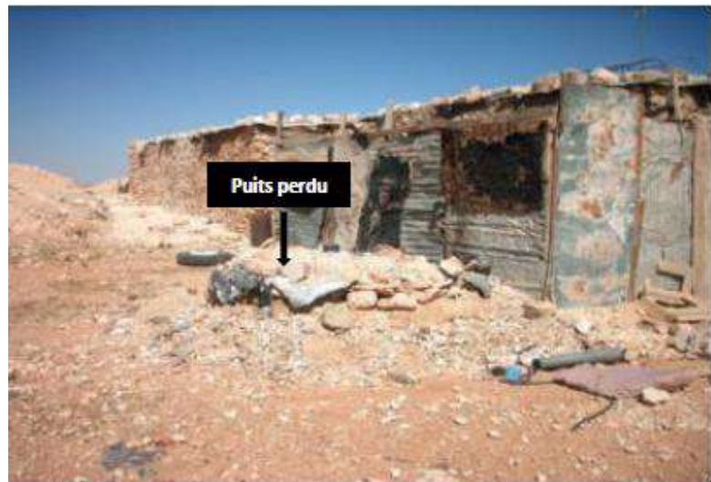
Figure 133 : évacuation des eaux usées vers les puits perdus (Source : Sofrani K , Juin 2009)
