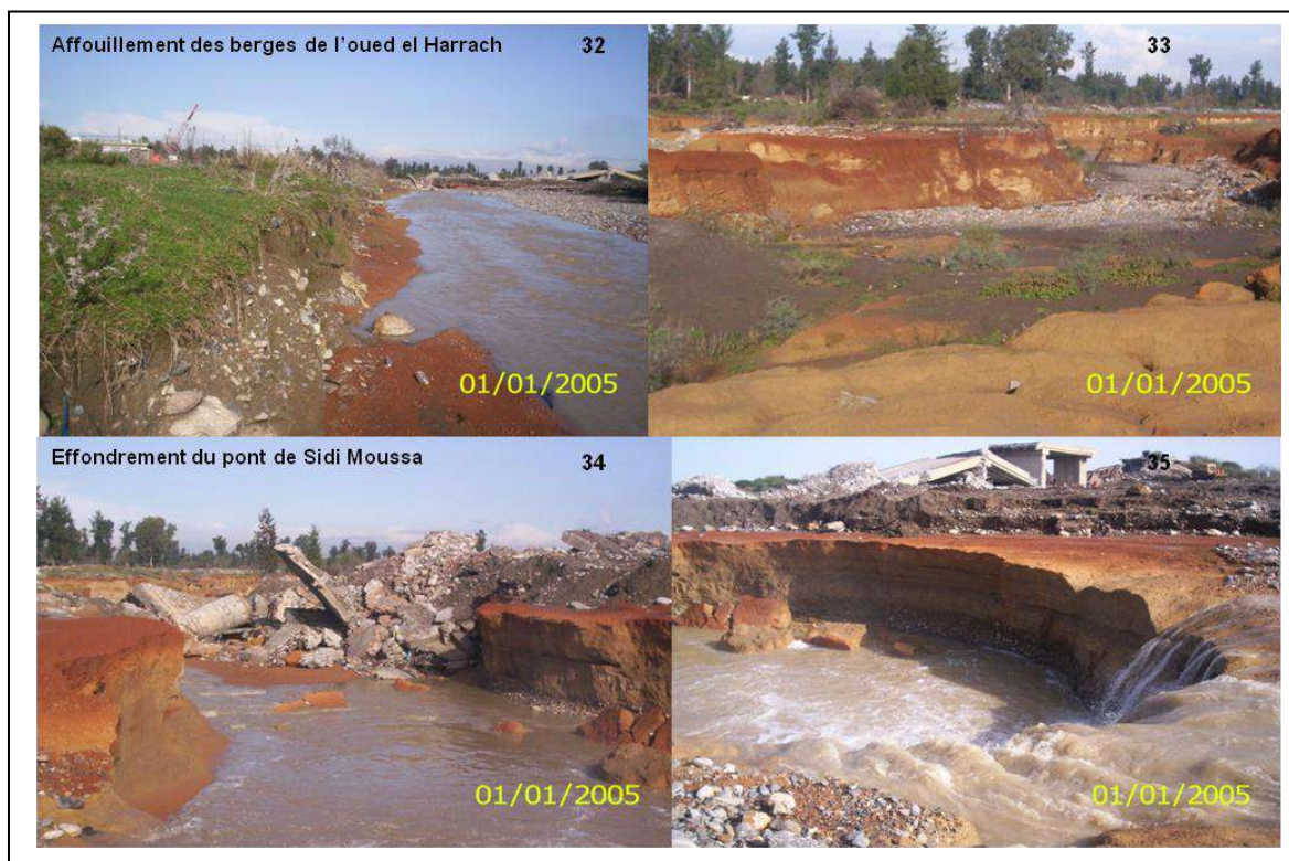
Photos 32-35 : Effondrement du Pont reliant Alger à Sidi Moussa, Hiver 2005 (A. BELKACEMI, Direction de l'Assainissement et de la Protection de l'Environnement, MRE).
