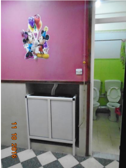
Figure 102. Le chauffage de l'étage « 1 » - (L'auteur -2016)
