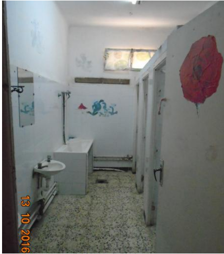
Figure 112. Sanitaire non fonctionnel à l'intérieur de la salle - (L'auteur -2016)
