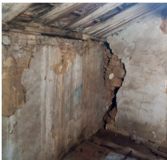
Figure 104: Fissure lézarde verticale, mur de face intérieur ouest, cour 1.
