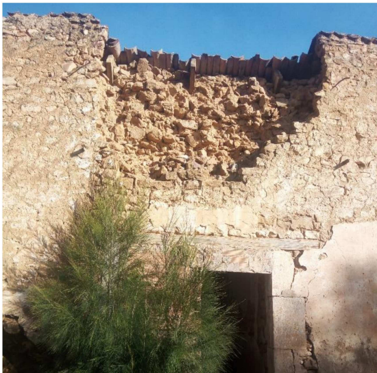
Figure 96: Effondrement partiel de mur au-dessus de l'entrée principale sud de la cour 1.
