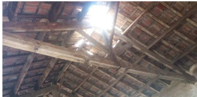
Figure 110: Une flèche au niveau d'un entrain de la charpente.
