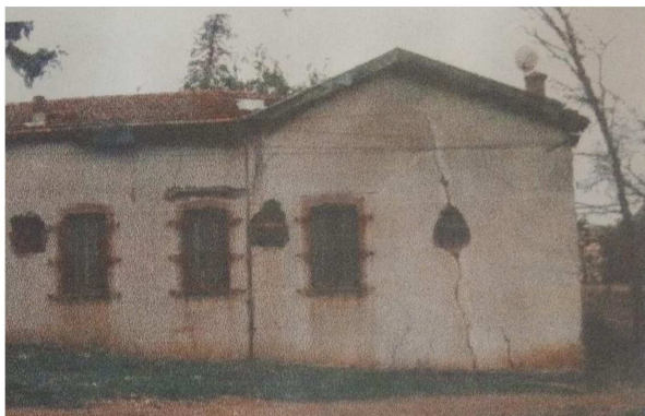
Figure 93 : Fissure vertical de type lézarde, mur de face extérieur ouest.
