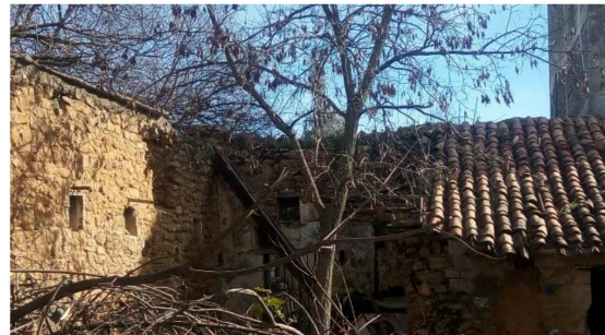
Figure 108: Effondrement de la charpente du coin nord-est, cour 1.
