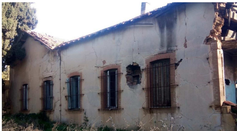
Figure 95 : Fissures lézardes verticales et à 45°, mur de face extérieur ouest
