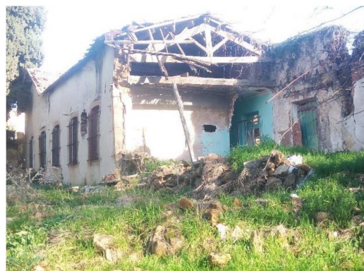
Figure 94 : Effondrement total d'une partie du mur de face extérieur ouest.
