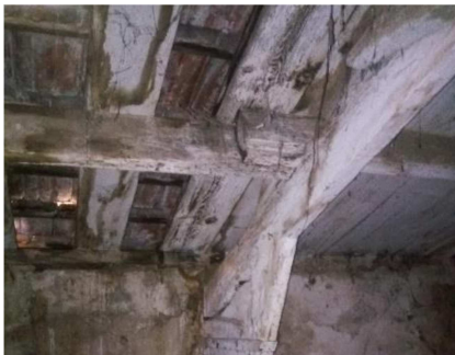
Figure 109: Pourrissement, charpente du comble.
