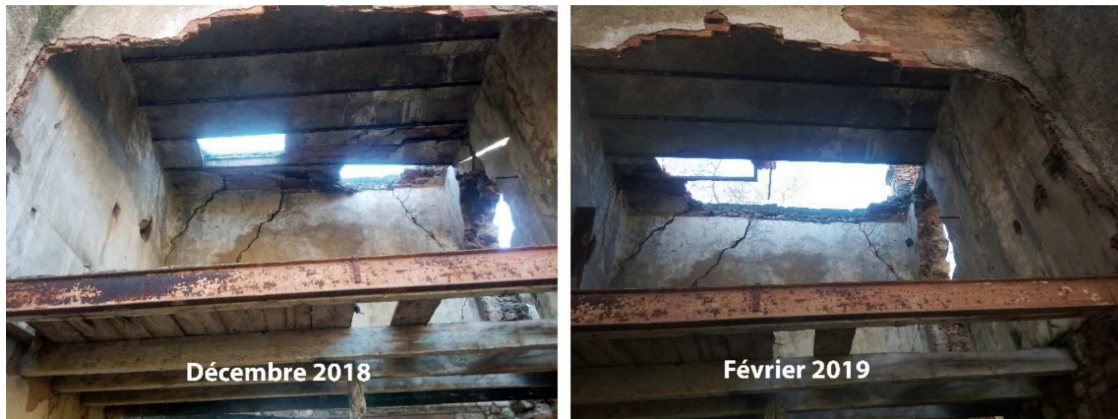
Figure 103: Effondrement partiel du plancher au-dessus de l'entrée de la cour 2.
