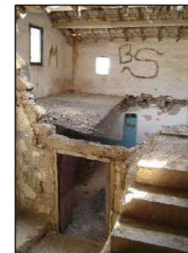
(d) Bâtisses partiellement effondrées
