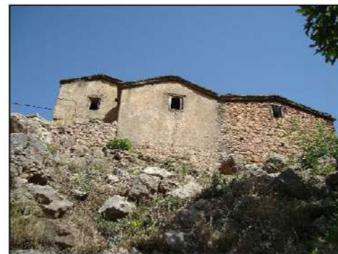
(b) Bâtisses présentant des anomalies
