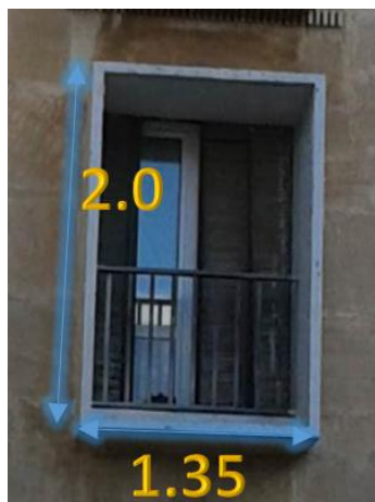
Figure 36 : porte fenêtre de la chambre (photo prise novembre 2016)
