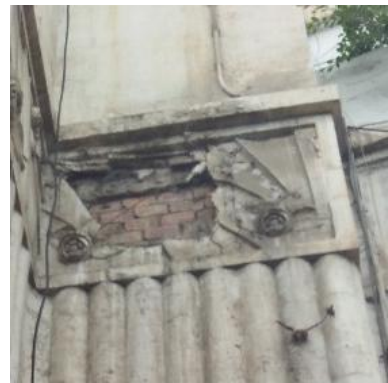
Fig.II.42: Fissure au niveau de la façade latérale.
