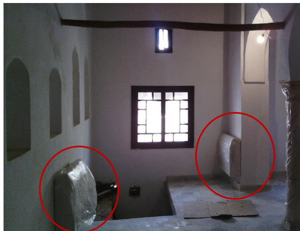
Photo 6: Salle polyvalente de la citadelle d'Alger. Climatisation mono-split. Source: HAMOUDI Hamza.
