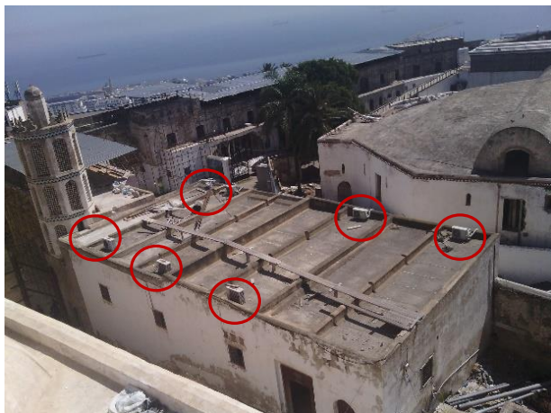
Photo 5: Citadelle d'Alger, vue d'en haut. Installation des climatiseurs mono-split au quartier des janissaires. Auteur: HAMOUDI Hamza
