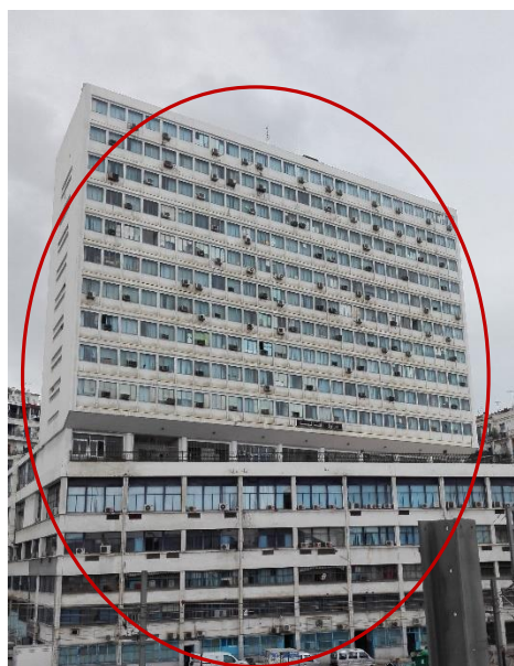
Photo 3: Ministère des finances, Alger centre. Installation des climatisations mono-split sur l'ensemble des espaces. Source: Auteure.
