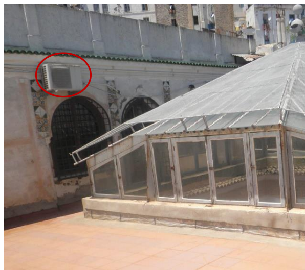
Photo 8: Dar Khdawedj El Amia, Casbah d'Alger. Climatiseurs mono-split en terrasse. Auteur: HAMOUDI Hamza.
