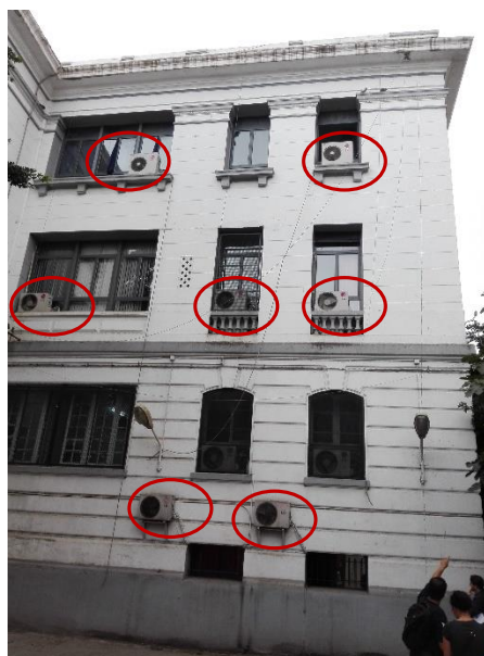
Photo 4: Ecole supérieure de commerce à Alger centre. Installation des climatiseurs mono-split. Source : Auteure.
