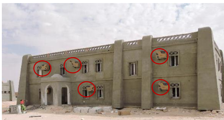
Photo 1: Base de vie de Debdeb, Bloc B3(A), installation des climatiseurs mono-split. Auteur: AZZOUG Walid.
