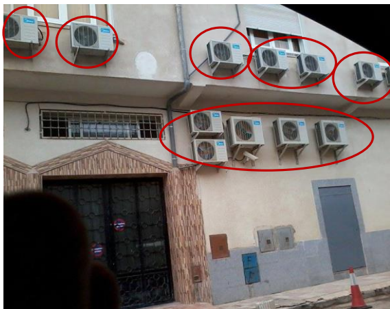
Photo 9: Climatisation mono-split sur une habitation individuelle à Sidi Belabbess. Auteurs: inconnu.
