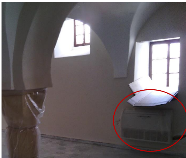
Photo 7: Citadelle d'Alger, quartier des janissaires. Installation des climatiseurs mono-split. Auteur: HAMOUDI Hamza.
