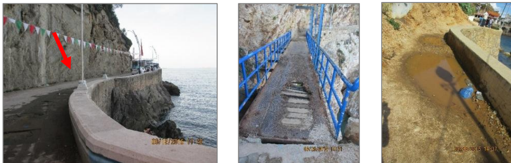
Figure 25: Manque d'entretien et d'insalubrité au niveau des deux corniches (Source : Auteur Août 2016)
